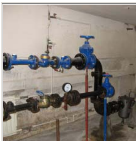
водомерный узел с магнитным шламоотводителем
