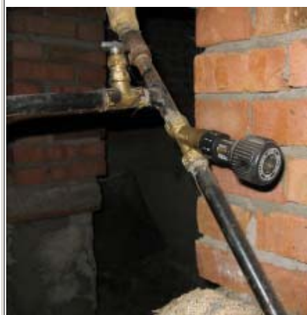
регулятор на стояках отопления
