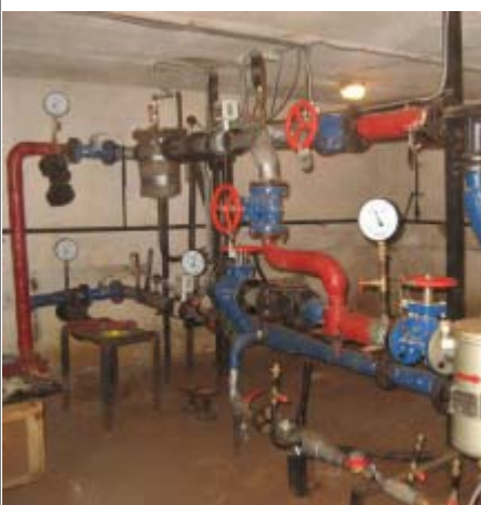
теплоцентр с магнитными шламоотводителями
