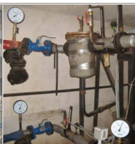
магнитный шламоотводитель на вводе в дом
